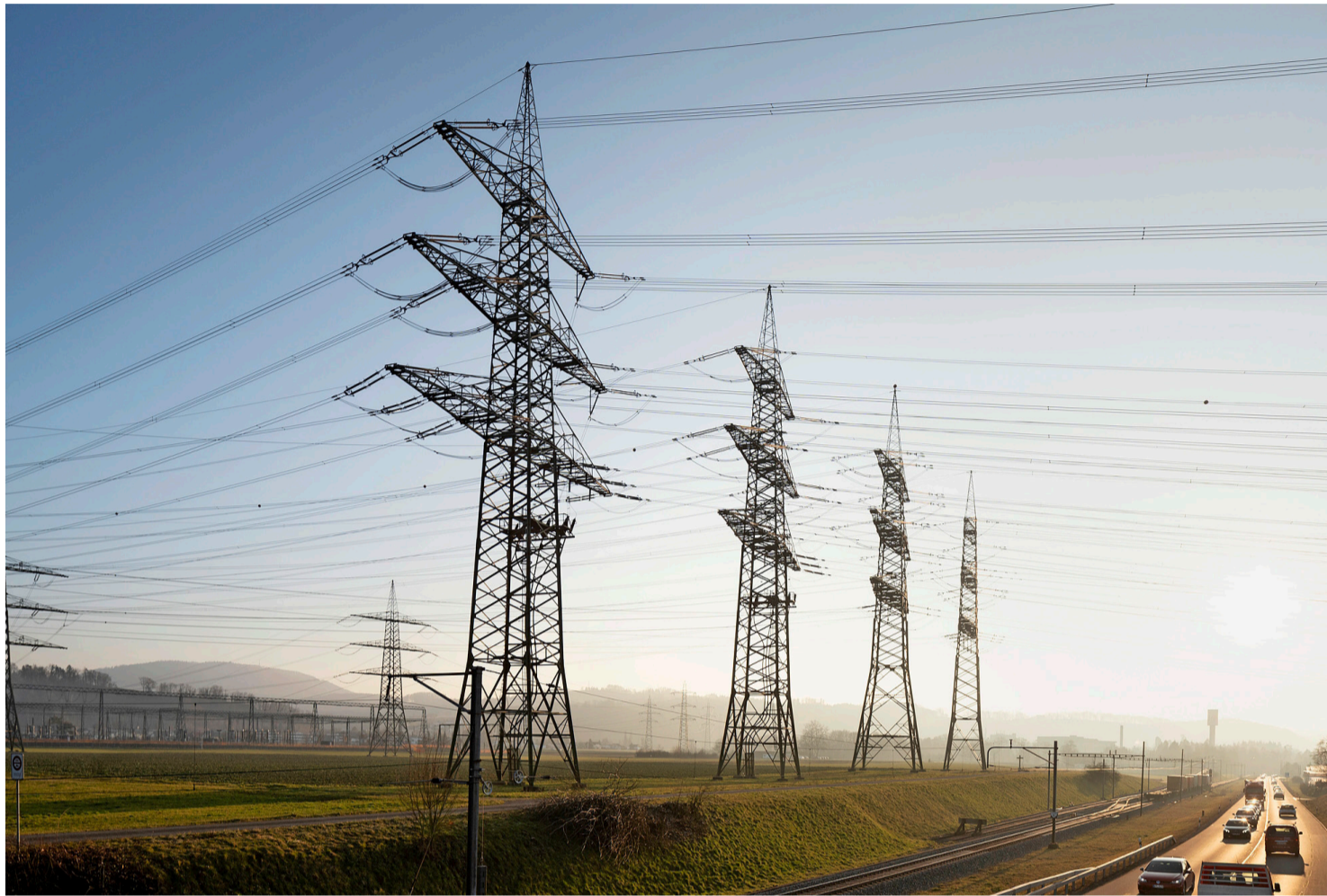
Wer Schaltanlagen in der Schweiz trifft, trifft Europa: 20 Prozent des europäischen Stroms fließen durch die Schweiz. Foto: Keystone
